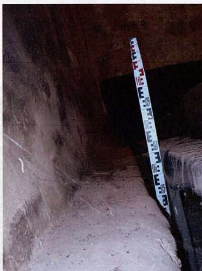
fig. 39 : ressaut présence sur la face interne du mur ouest
