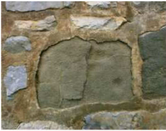
Exemple des dégâts occasionnés par des joints de ciment autour de pierres relativement tendres : le grès briovérien est désormais en creux. Le grès quartzite, dur, quasi imperméable, n'en souffre pas.
