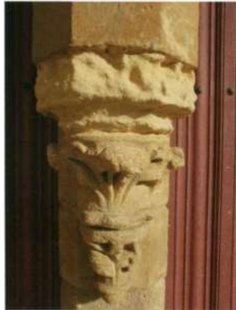
Trumeau. Le bloc de tuffeau reposant directement sur le granité à grain fin (partie sculptée) a beaucoup souffert de la rétention d'eau au dessus de ce granité beaucoup moins perméable. En haut, le bloc de tuffeau a dû être changé.
